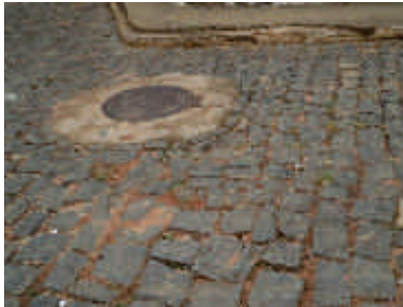
FIGURA 50 - POÇO DE VISITA (FONTE: ACERVO DO AUTOR, 2014)
