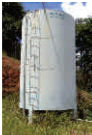
FIGURA 35 - RESERVATÓRIO DA LOCALIDADE DE APARECIDA (FONTE: ACERVO DO AUTOR, 2014)
