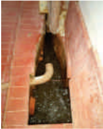
FIGURA 7 - CALHA PARSHALL (FONTE: ACERVO DO AUTOR, 2014)
