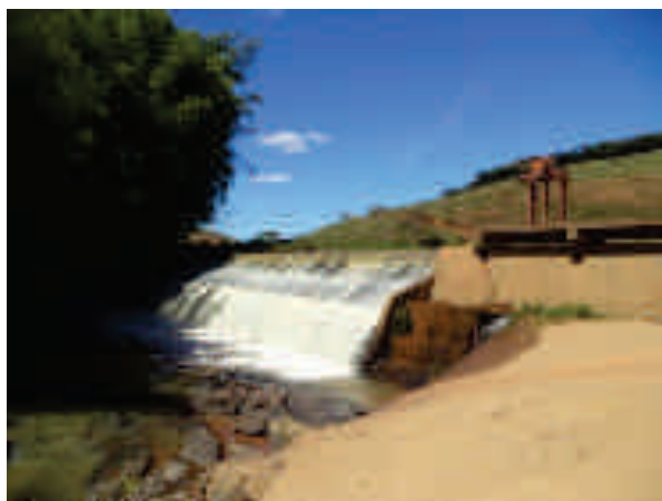
FIGURA 5 - CAPTAÇÃO (VISTA 1) (FONTE: ACERVO DO AUTOR, 2014)
